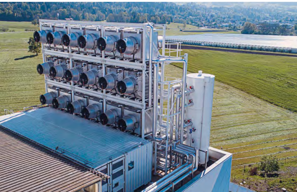
Die «Direct Air Capture»-Pilotanlage von Climeworks in Hinwil in der Schweiz Foto: Julia Dunlop / Climeworks
