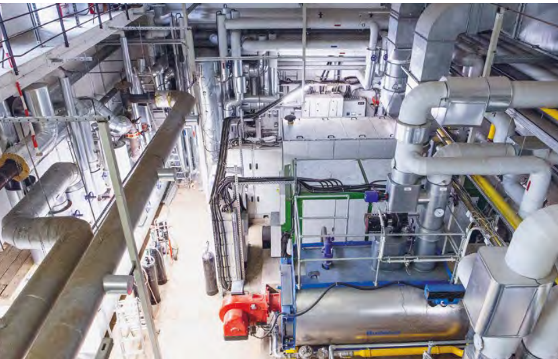
Im Heizhaus im Quartier Heidrehmen in Hamburg werden durch die Modernisierung der Wärmeversorgung nun Emissionen eingespart. Foto: Maria Feck
