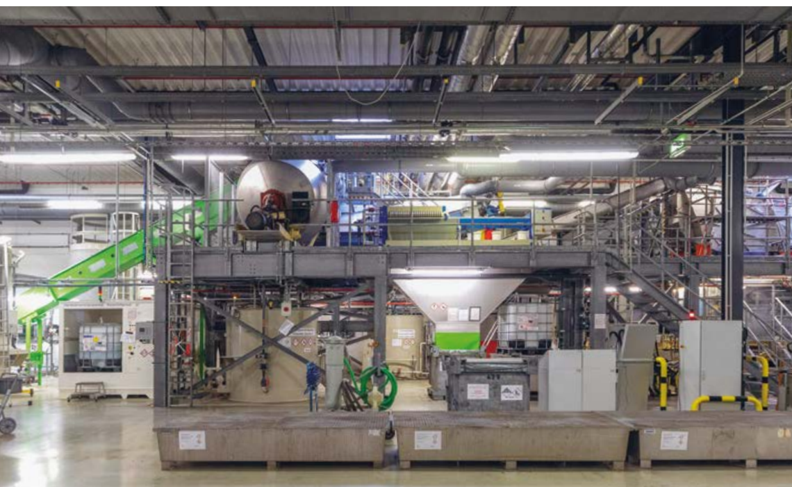
In diesem Bereich der Anlage werden die in einem Solarmodul verbauten Stoffe voneinander getrennt. Das Förderband links transportiert die zerstoßenen Module zur Waschtrommel. Am anderen Ende der Anlage wird das Halbleitermaterial wiedergewonnen. * Foto: Silke Reents
