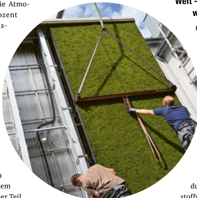
Maos am Bau: Die «Wohnungsgenossenschaft Gartenheim» aus Hannover hat ein Bewässerungssystem für Mooswände entwickelt und bereits an mehreren Gebäuden installiert. Foto: gartenheim.de
